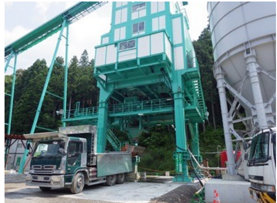
写真—7 コンクリート生産設備
