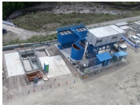
写真—9 濁水処理設備
