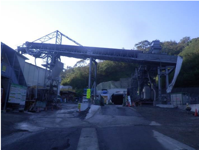
写真-2 坑外ベルトコンベヤ
