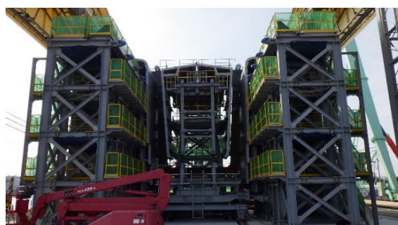
写真-2 セグメント製作設備
