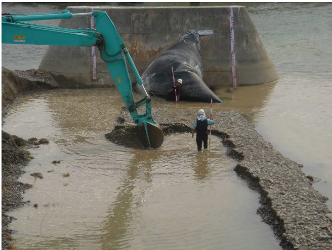
Fig.4 出水後における堆積土砂の状況
