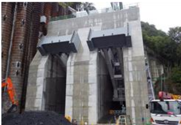
写真-2 吐口ゲート設備（下流側より撮影）
