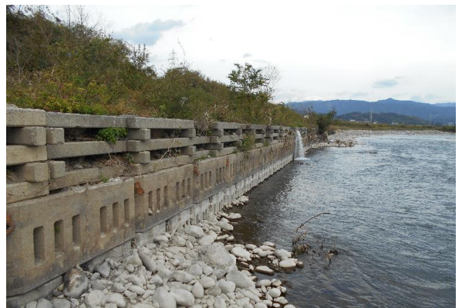
出水による被災状況(巨石の流出)
