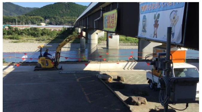
回転灯+警報音による作業員への警告
