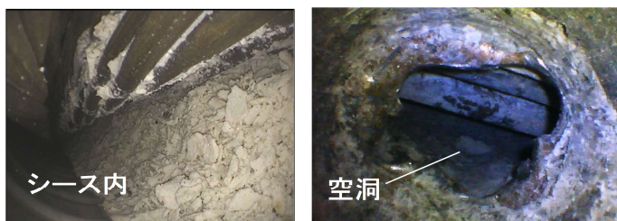
写真 - 1 シース内のグラウト未充填状況
