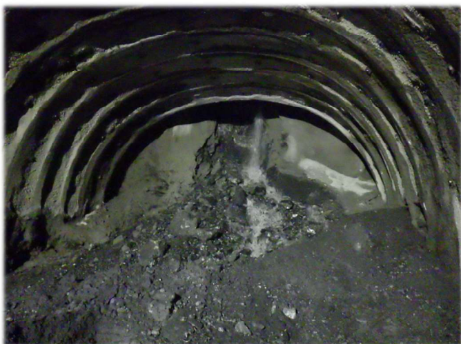
写真2 横島トンネル突発湧水
