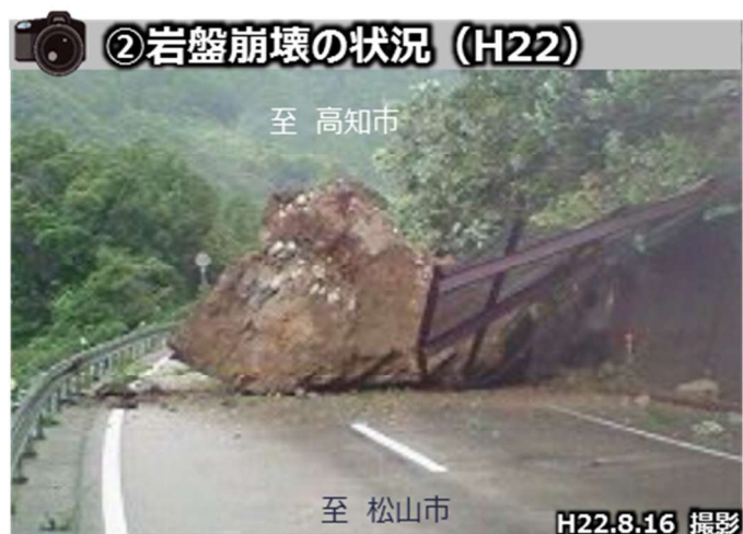
写真7 岩盤崩壊の状況(H22)
